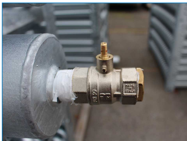
Horní připojení TVT s pojistným tlakovým ventilem na kondenzátorech.
