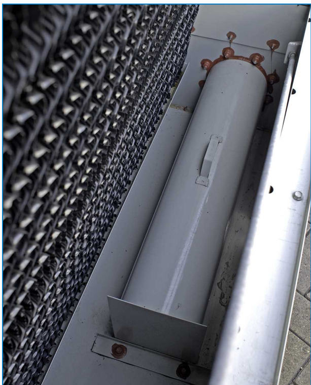
Nádrž na ochlazenou vodu a filtry nádrže
