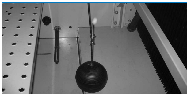
Ohřivač sběrné nádrže
