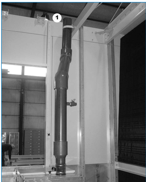
Potrubí čerpadla, dolní sekce
